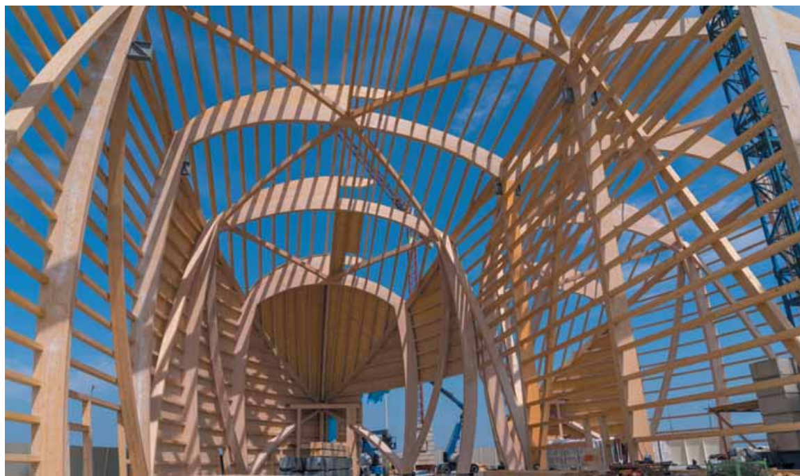
GIGANTESCO. Lo scheletro in legno che contiene e supporta l'intera struttura che ospita i due nuovi hangar per la manutenzione degli yacht. La realizzazione di costruzioni di questo tipo ad uso industriale è una novità
